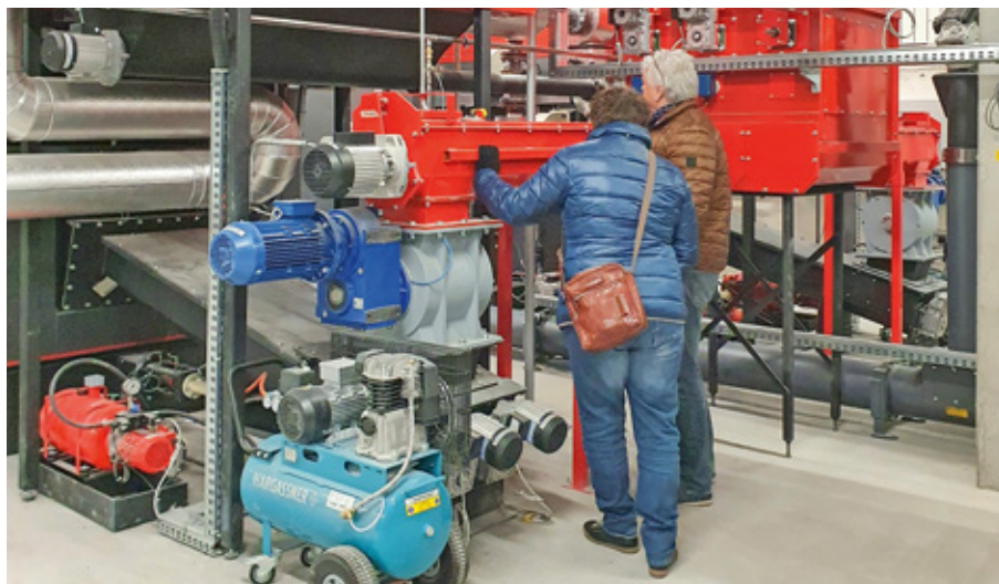
Die Genossenschaftsmitglieder Bernadette und Hugo Koch inspizieren die Anlagen in der neuen Heizzentrale. Bild: Werner Weibel
