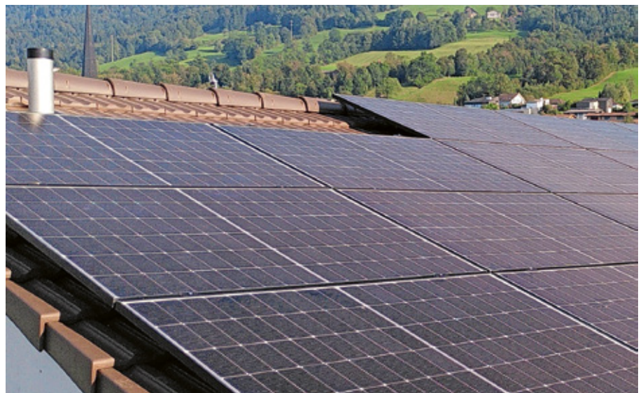
Die neue Anlage im Oberfeld 5+7 ist seit 21. September in Betrieb. Bild: zvg
